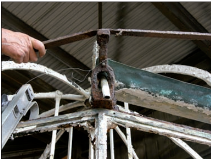
Lanterninen där bl.a. vattenutkastarna saknades.
